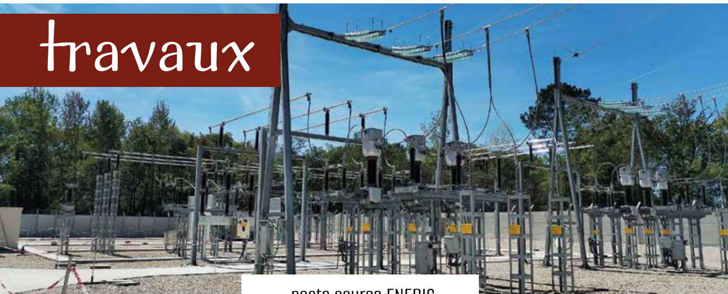
poste source ENEDIS
